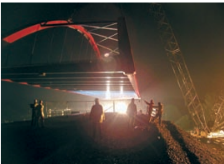
Die Brücke kurz vor ihrem Ziel und Anfahrt des 160 to Krans für das Aushängen der Seile.
